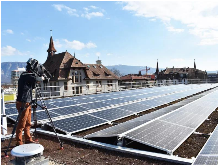
Figure 7: Centrale photovoltaïque de l'école du Petit Lancy. Source : Commune de Lancy, https://www.lancy.ch/mon-m2-solaire-une-demarche-novatrice .
