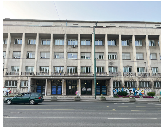
Impacts de balles sur le bâtiment administratif fédéral
